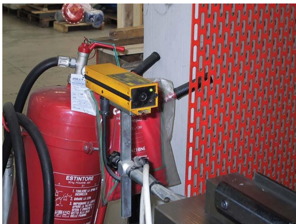
Figura 2 – Dispositivo di sicurezza a fotocellula
